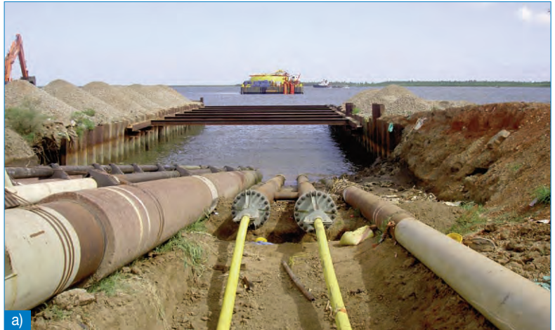
a) Landfall cable conduits.
